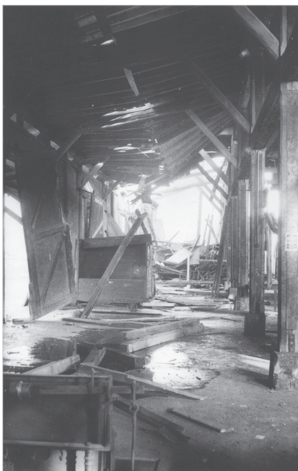
doc. 7 Les bâtiments de la gare ont leurs toitures très fortement endommagées
