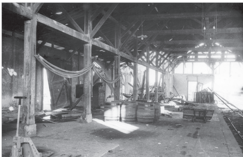
doc. 8 Dans ces bâtiments, les cloisons ont été détruites, et les poutrelles des charpentes sont tordues
