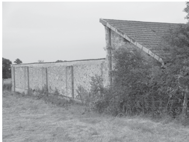
«Ruines» de la façade Ouest du hangar en 2014.
